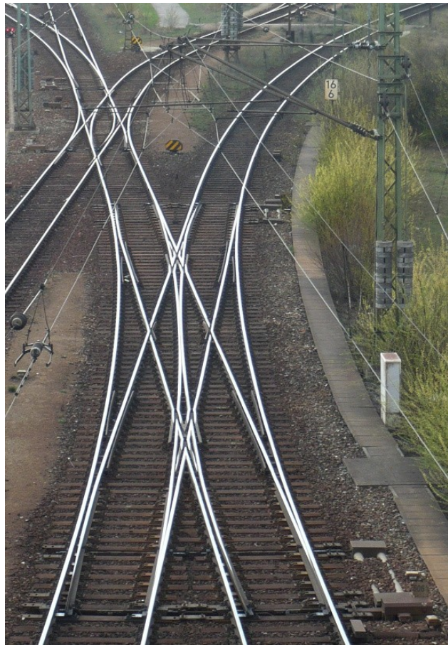
Oberleitung über einer DKW mit außen liegenden Weichenzungen
