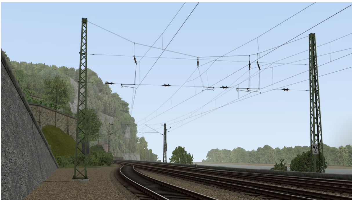
Unterschiedliche Neigung der Isolatoren je nach Kurvenradius
